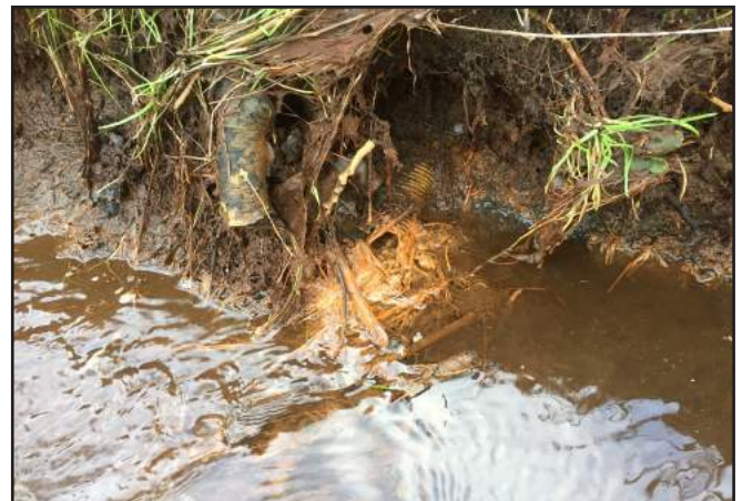
Abb. 77: Eiseneintrag durch Drainageleitungen an der Probestrecke „Welsetal“, 18.02.2018
